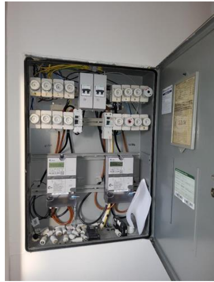
Elektrisk anlegg - [Sikringskapet]
