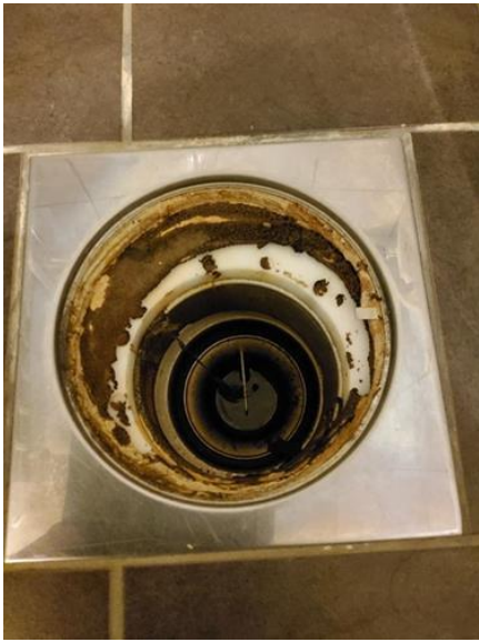
Våtrom - [Sluk på bad ]
