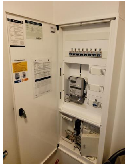
Elektrisk anlegg - [Sikringskapet ]
