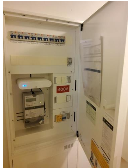
Elektrisk anlegg - [Sikringsskapet]
