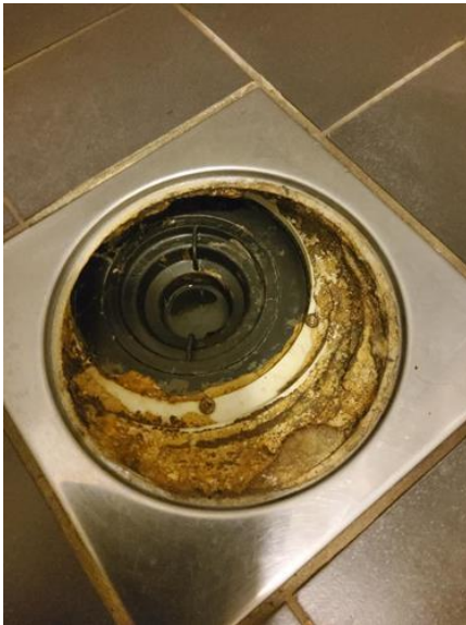
Våtrom - [Sluk på bad]
