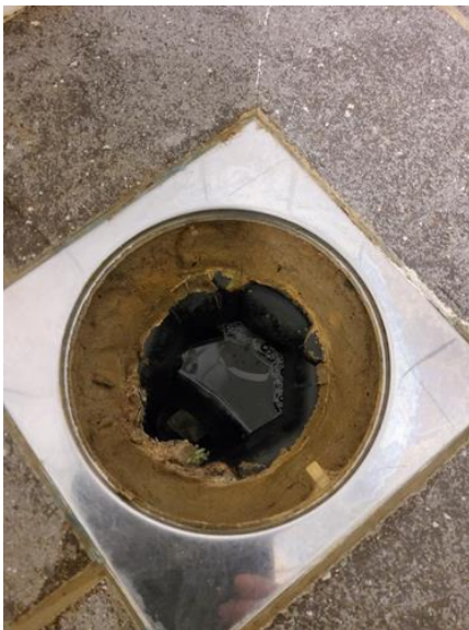
Våtrom - [Sluk på bad i underetasjen ]
