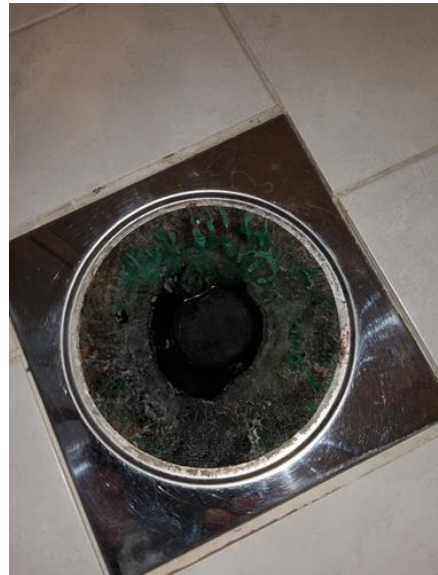
Våtrom - [Sluk på bad i 2. etg.]
