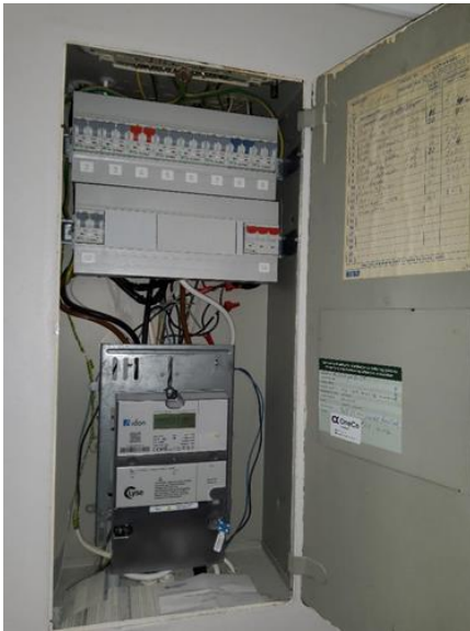
Elektrisk anlegg - [Sikringskapet i hoveddelen ]
