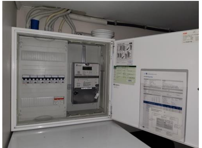
Elektrisk anlegg - [Sikringskapet i hybelen]
