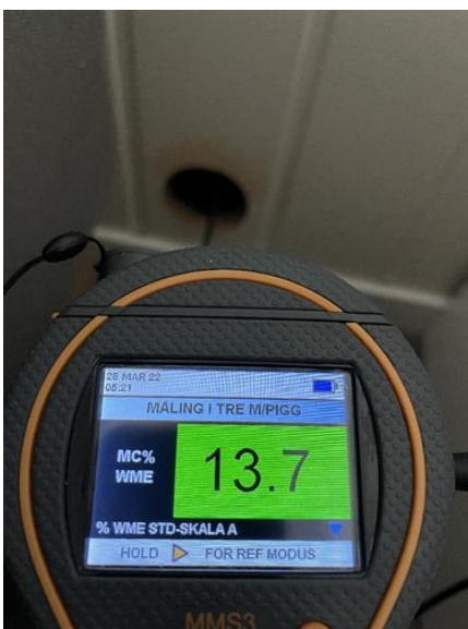
Konstruksjoner (tilfarergulv, himling og vegger). - [Fuktmåling i kjellervegg]
