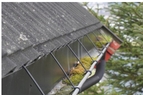
Mosedannelse i takrenne
