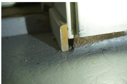
Utetthet ved dør (våtsone)
