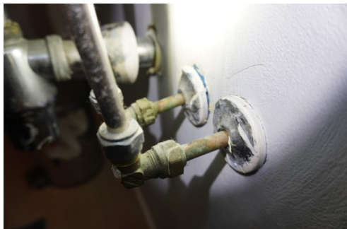
Irrdannelse på kobberør.
