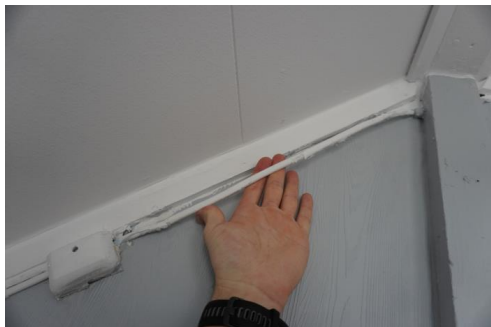
Kabel ikke tilstrekkelig festet.
