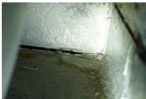
Utetthet i gulvbelegg - bak varmtvannsbereder.
