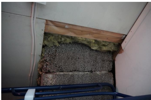
Brudd i dampsperre ved gjennomføring av pipe.
