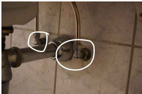
Utett gjennomføring - Under servant
