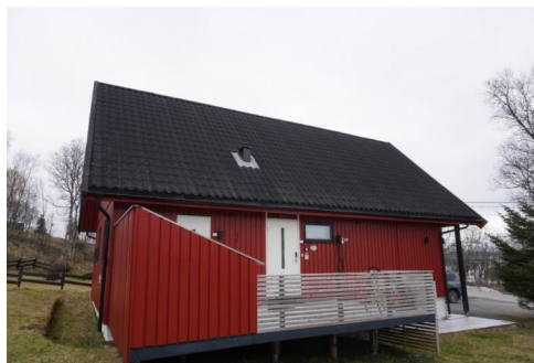
Manglende snøstoppere i gangsone
