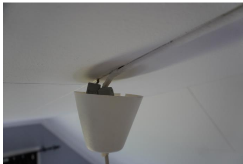
Ikke forsvarlig kapslingsgrad - taklampe.
