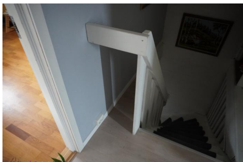
Åpning i rekkverk
