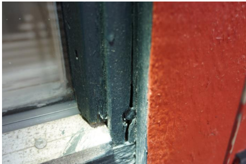
Sprekk i vinduskarm - Sør fasade
