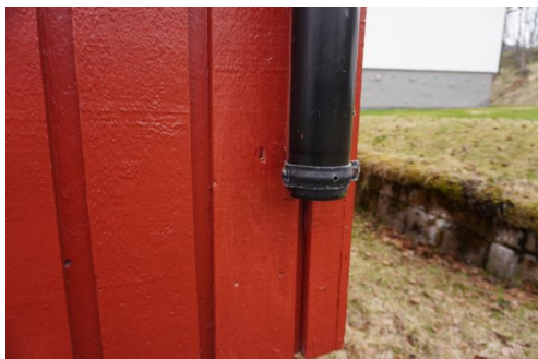
Manglende bend/utkast og nedløp avsluttet over kledningen
