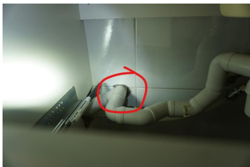
Utett gjennomføring bak innredning
