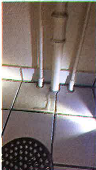
Våtrom - [Vannlekkasje vaskerom]
