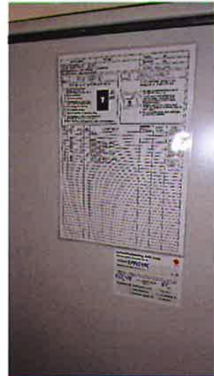
Elektrisk anlegg - [Sikringskap 2.]
