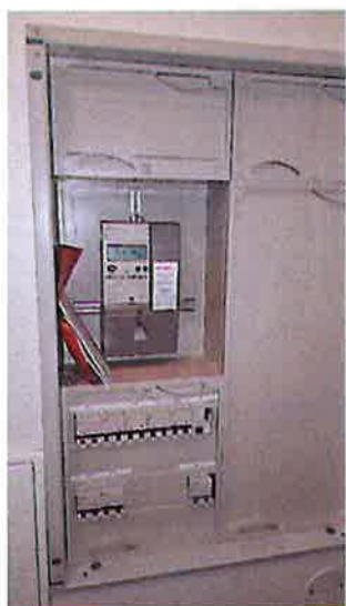
Elektrisk anlegg - [Sikringskap 1.]
