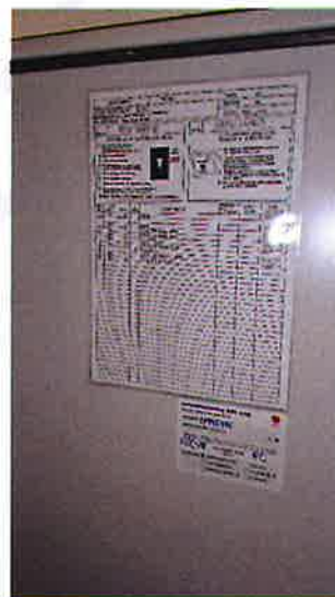
Elektrisk anlegg - [Sikringskap 2.]
