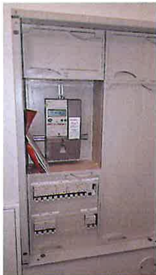
Elektrisk anlegg - [Sikringskap 1.]
