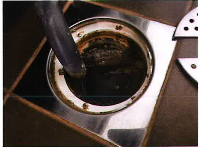
Våtrom - [Sluk bad 1.etg]
