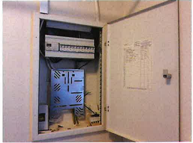
Elektrisk anlegg - [Sikringskap underetasje]
