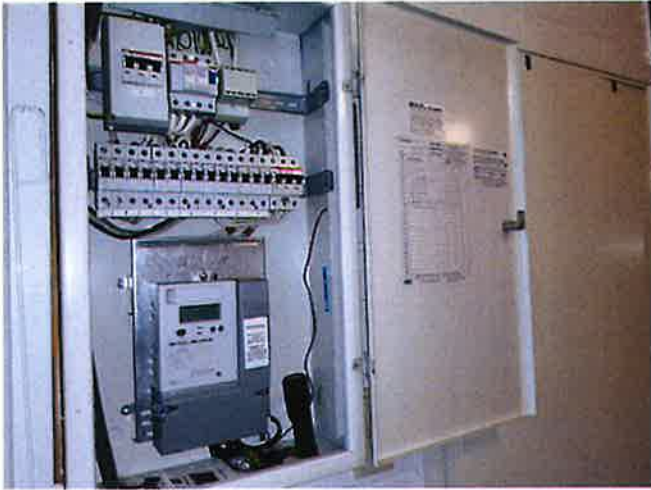
Elektrisk anlegg - [Sikringsskap 1.etg ]
