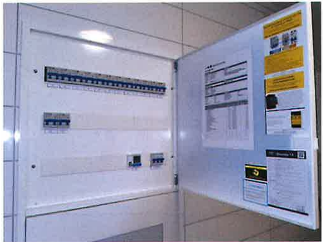
Elektrisk anlegg - [Sikringskap ]
