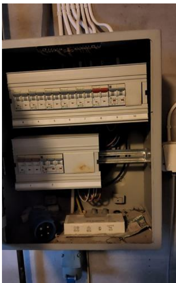
Elektrisk anlegg - [Sikringskap teknisk rom]
