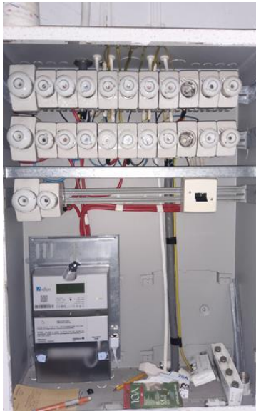
Elektrisk anlegg - [Sikringskap i bod]
