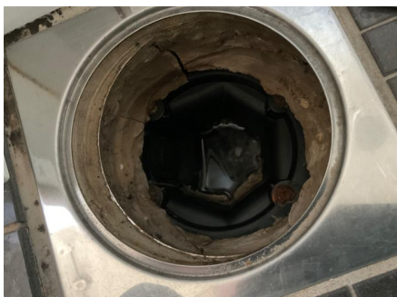
Ingen synlig membran i sluket
