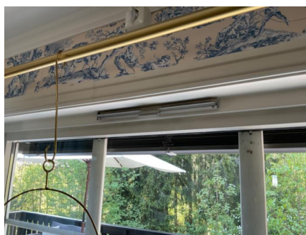
Tilluftsventiler i vinduer
