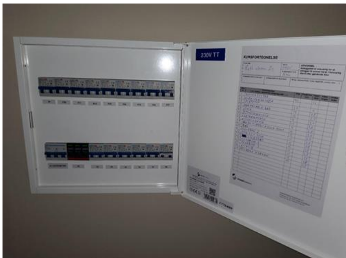
Elektrisk anlegg - [Sikringsskap.]
