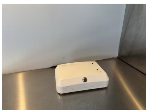
Komfyrvakt er montert.
