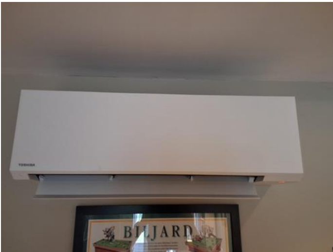
Tekniske anlegg, VVS anlegg (Sjekkpunkter utover det som er inkludert i andre rom) - [Luft til luft varmepumpe i tv- stuen]
