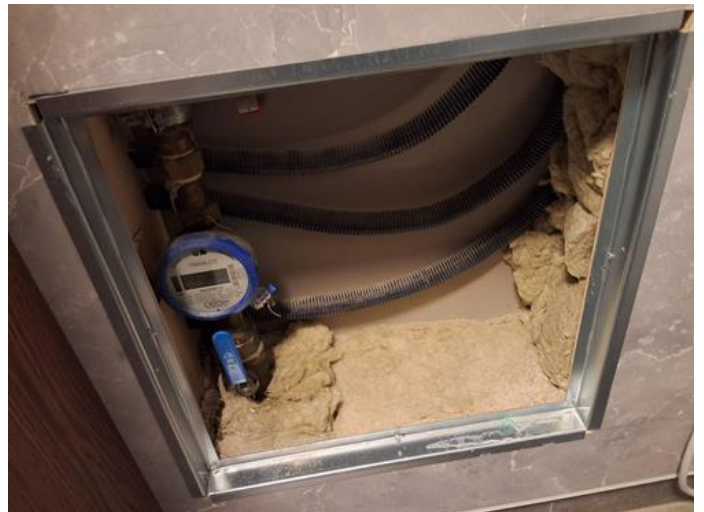
Tekniske anlegg, VVS anlegg (Sjekkpunkter utover det som
