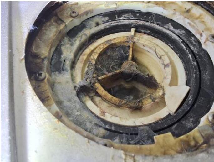
Avløpsrør (ink. sluk) - [Hovedsluk bad underetasje]
