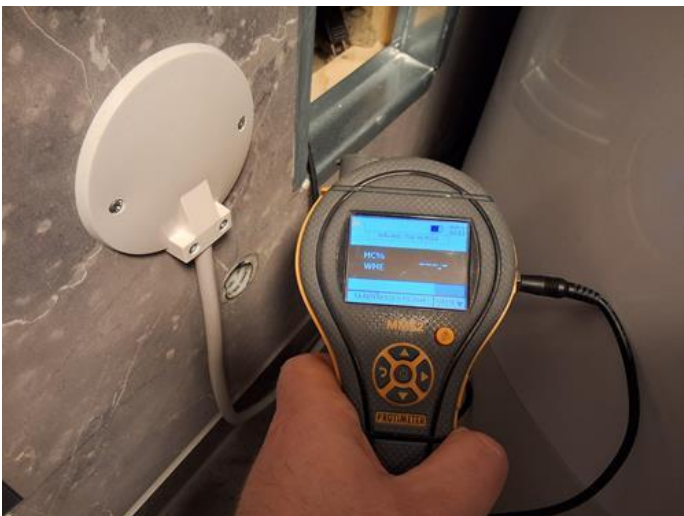
Våtrom - [Fuktmåling bad underetasje]
