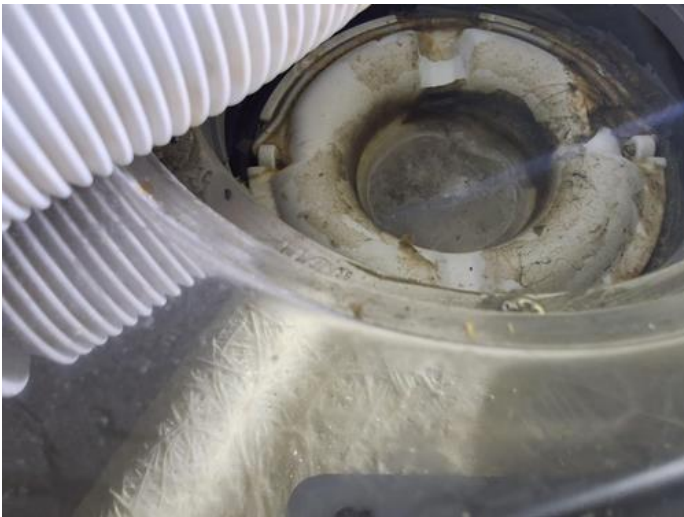
Avløpsrør (ink. sluk) - [Sluk bad 1.etg]
