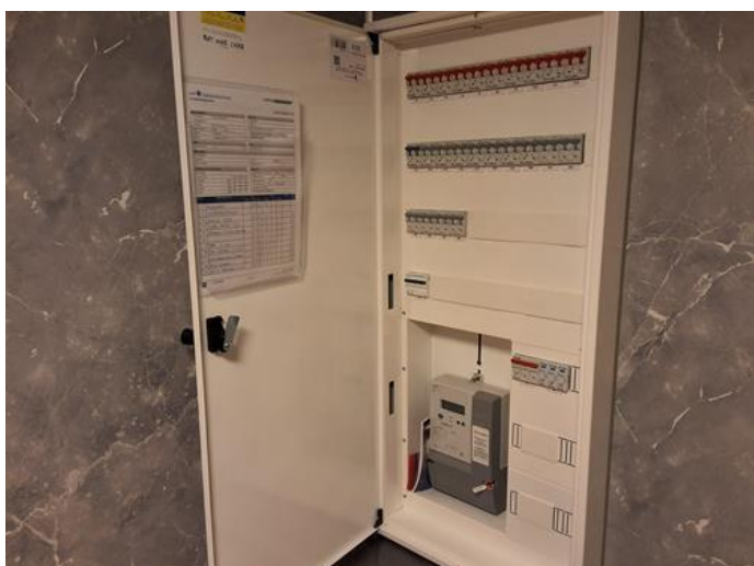
Elektrisk anlegg - [Sikringskap ]
