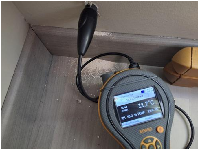
Konstruksjoner (tilfæregulv, himling og vegger). - [Fuktmåling i utlektet kjellevegg]
