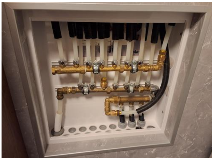
Tekniske anlegg, VVS anlegg (Sjekkpunkter utover det som er inkludert i andre rom) - [Fordelerskap for rør-i-rør-systemet på vaskerom ]
