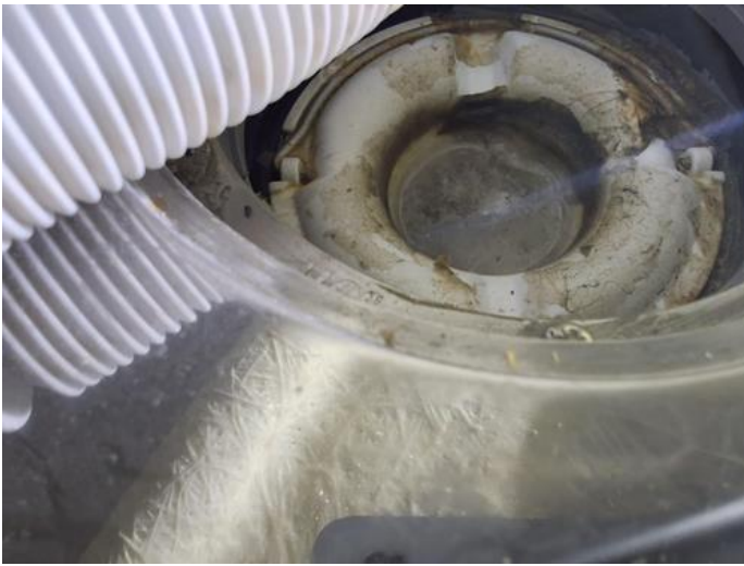
Avløpsrør (ink. sluk) - [Sluk bad 1.etg]
