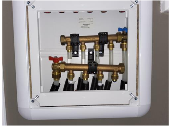
Tekniske anlegg, VVS anlegg (Sjekkpunkter utover det som er inkludert i andre rom) - [Fordelerskap for rør-i-rør ]
