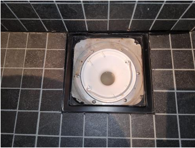
Våtrom - [Sluk på bad.]
