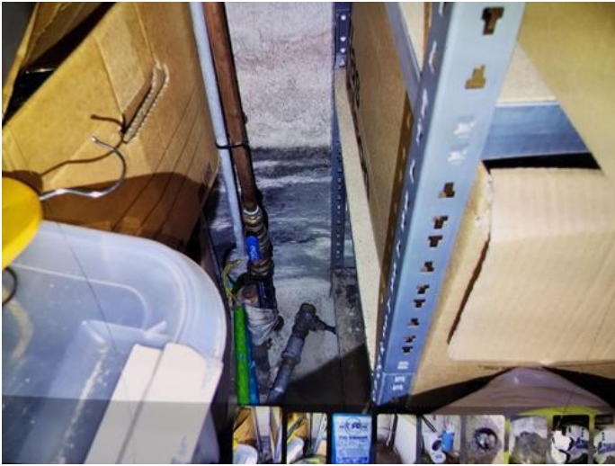
Tekniske anlegg, VVS anlegg (Sjekkpunkter utover det som er inkludert i andre rom) - [Stoppekran ]
