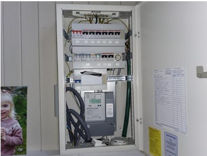
Elektrisk anlegg - [Sikringskap ]
