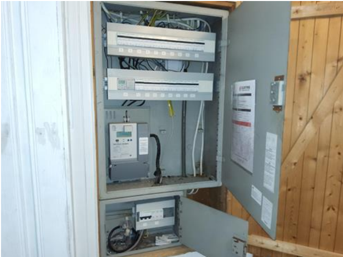
Elektrisk anlegg - [Sikringskap ]
