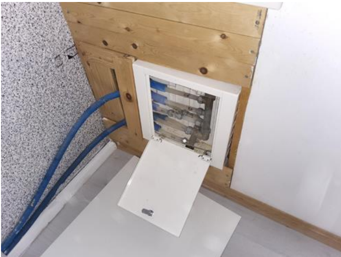
Våtrom - [Fordelerskap for rør-i-rør ]
