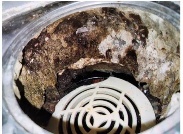
Våtrom - [Sluk på bad 3]
