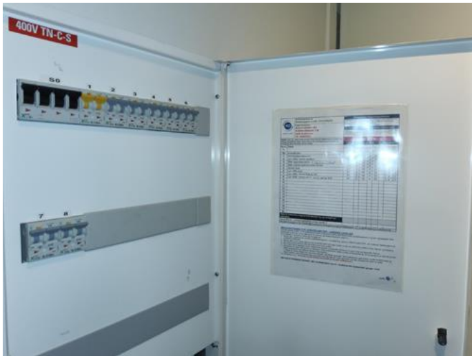
Beskrivelse - [Sikringskap med kursfortegnelse. ]
