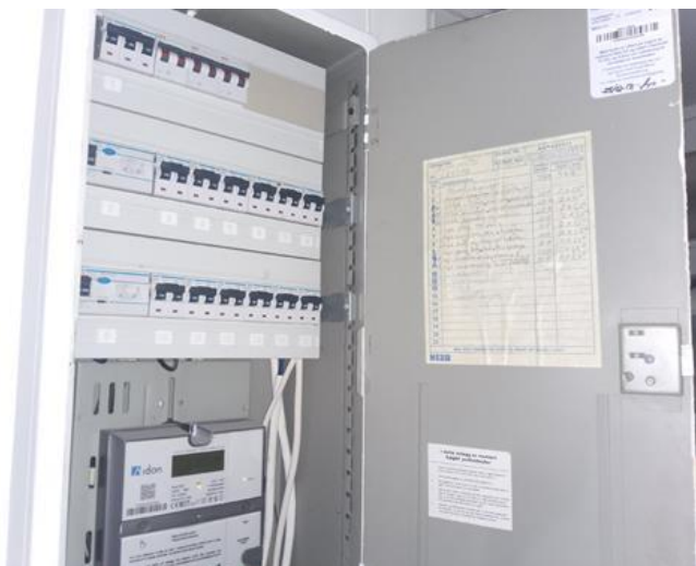
Beskrivelse - [Sikringsskap og kursfortegnelse ]
