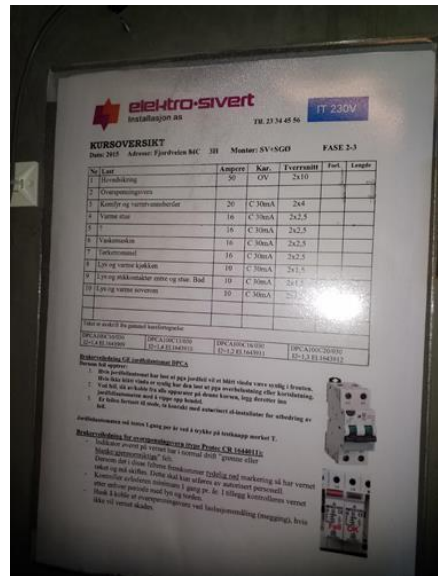
Elektrisk anlegg - [IMG_20231121_111329]
