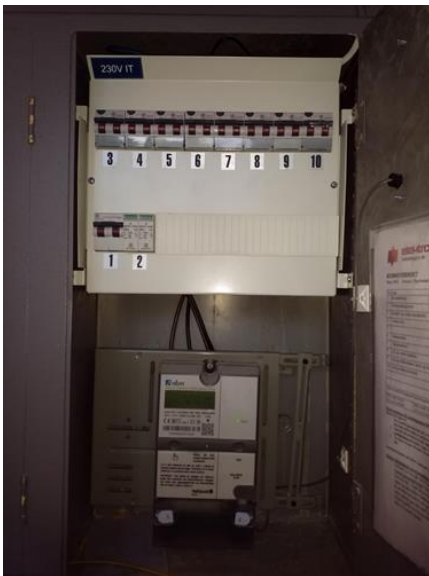
Elektrisk anlegg - [IMG_20231121_111312]
