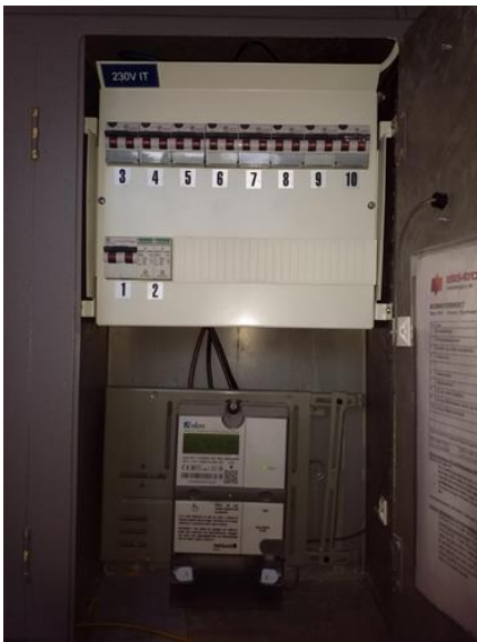
Elektrisk anlegg - [IMG_20231121_111312]
