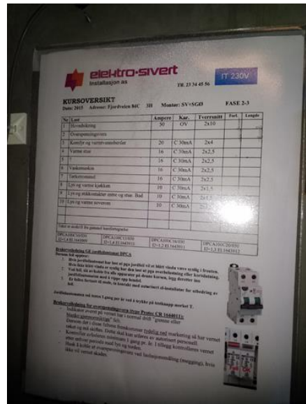
Elektrisk anlegg - [IMG_20231121_111329]
