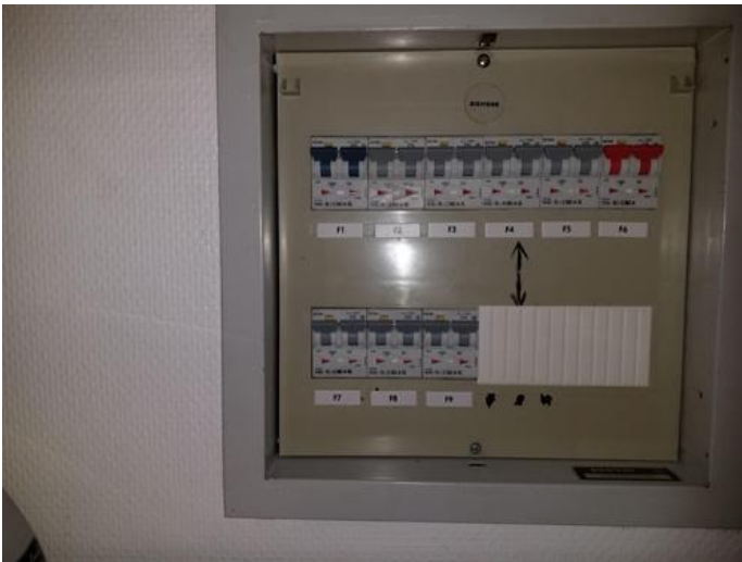
Elektrisk anlegg - [Sikringskap.]
