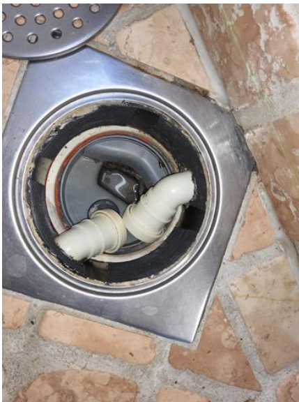
Kommentar - [Sluk bad 2.etasje ]
