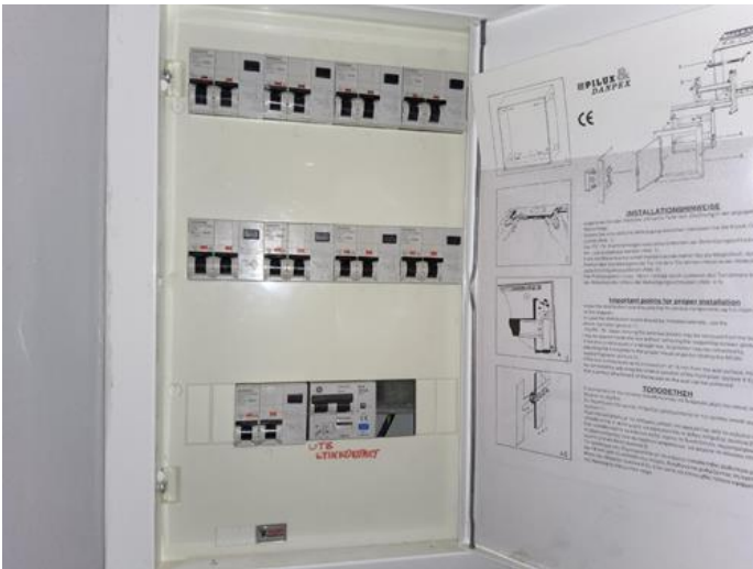
Beskrivelse - [Sikringskap kjeller]
