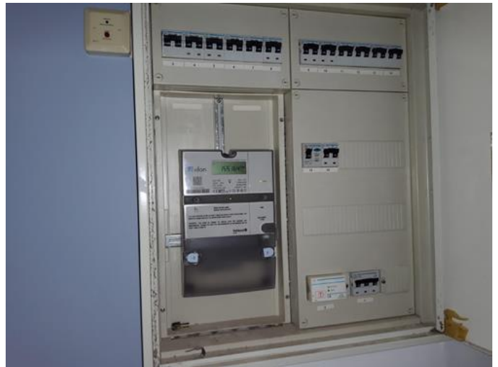
Elektrisk anlegg - [Sikringskap]
