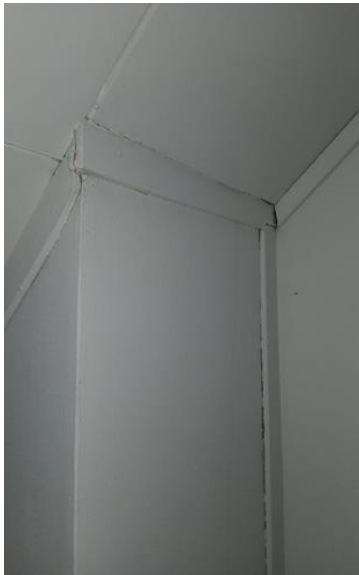
Overflater himling/undertak - [Fuktmerker/svelleskader]
