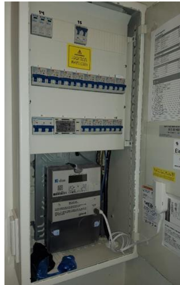
Elektrisk anlegg - [Sikringskap]
