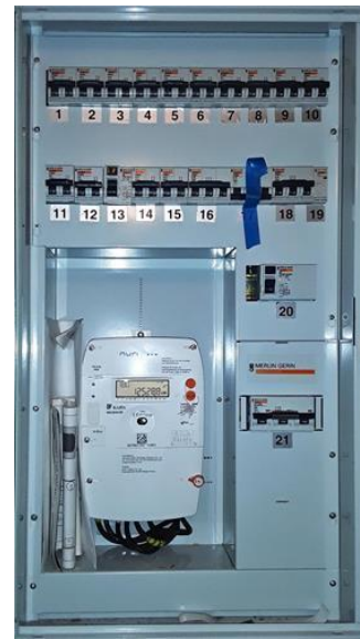
Elektrisk anlegg - [Sikringskap]
