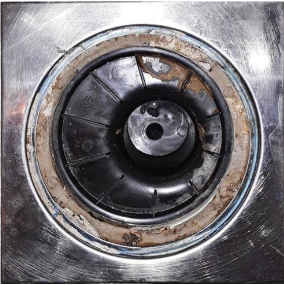
Våtrom - [Sluk bad 1. etasje]
