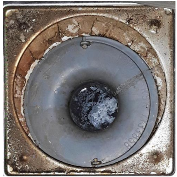
Våtrom - [Sluk bad underetasje]
