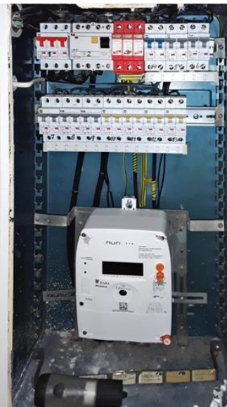
Elektrisk anlegg - [Sikringsskap]
