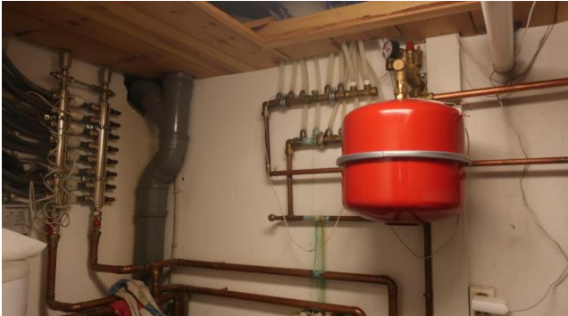
Vannrør til andre etasje.
