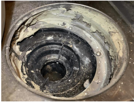
Plastsluk, og synlig tettesjikt under slukets klemring.
