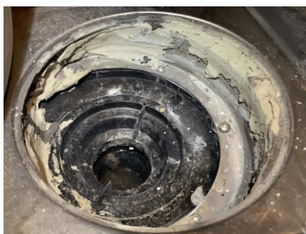
Plastsluk, og synlig tettesjikt under slukets klemring.
