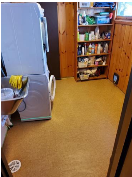
Helhetsvurdering - [Vaskerom med høy alder og slitasjegrad. ]
