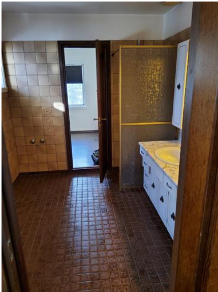
Helhetsvurdering - [Bad 1.etasje har høy alder og slitasjegrad ]
