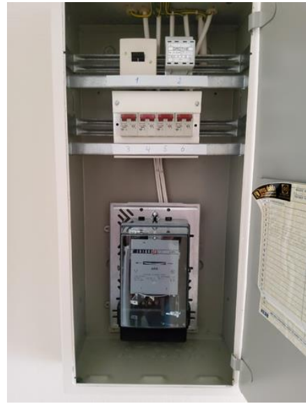
Elektrisk anlegg - [Sikringskap underetasje ]
