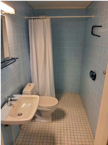
Helhetsvurdering - [Bad i underetasje med høy alder og slitasjegrad ]
