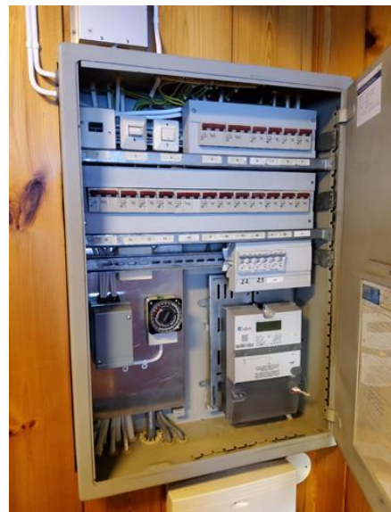
Elektrisk anlegg - [Sikkeringskap 1.etasje ]
