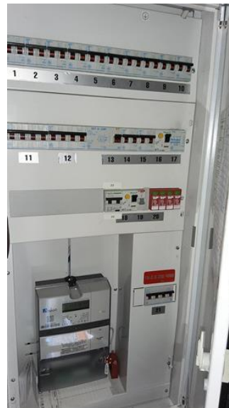
Elektrisk anlegg - [Sikringsskap ]
