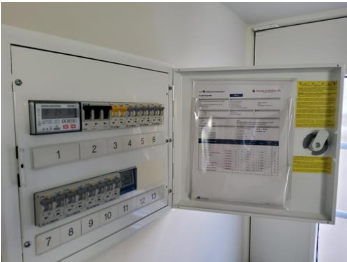
Elektrisk anlegg - [Kursfortegnelse hybel. ]
