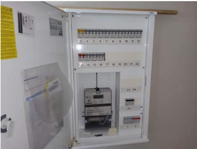
Elektrisk anlegg - [Sikringskap 2.etasje.]
