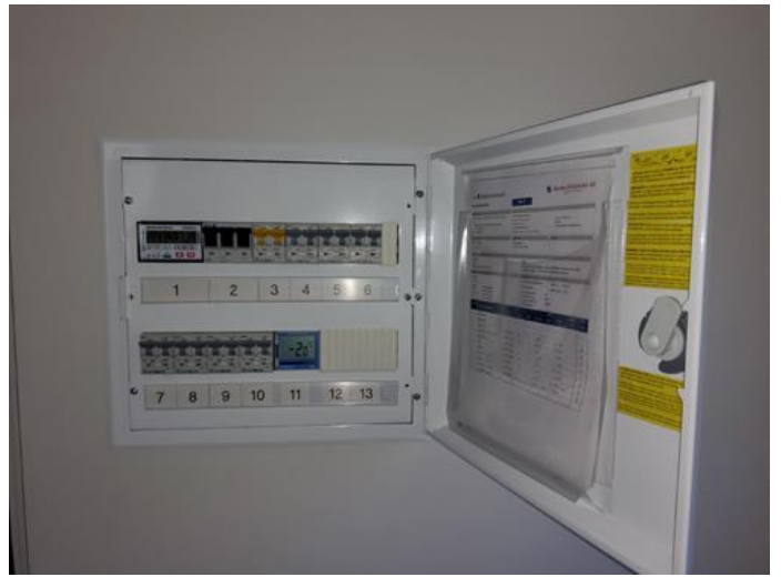
Elektrisk anlegg - [Sikringskap hybel. ]
