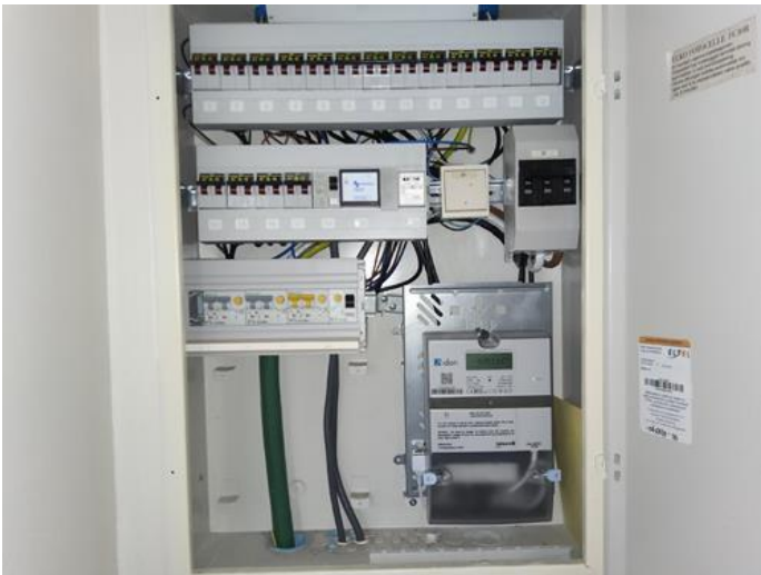
Elektrisk anlegg - [Sikringskap]
