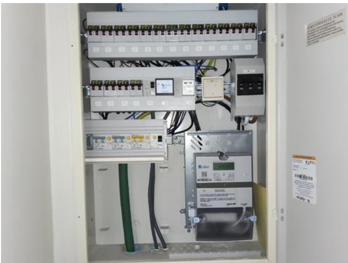
Elektrisk anlegg - [Sikringskap]
