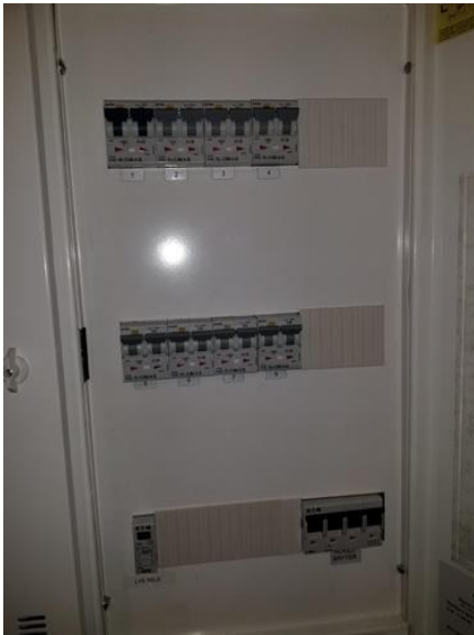
Elektrisk anlegg - [Sikringsskap]
