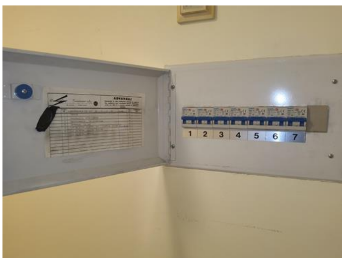
Beskrivelse - [Sikringsskap og kursfortegnelse]
