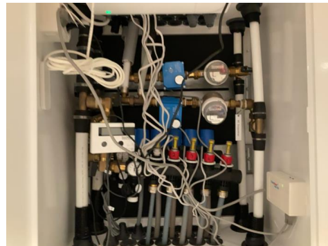
Fordelerskap i bad
