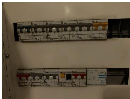
Synlige åpninger i sikringsskap
