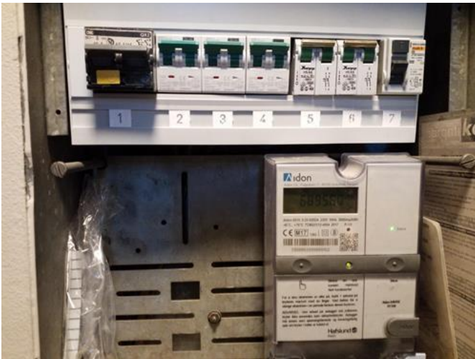
Elektrisk anlegg - [Sikringskap. ]
