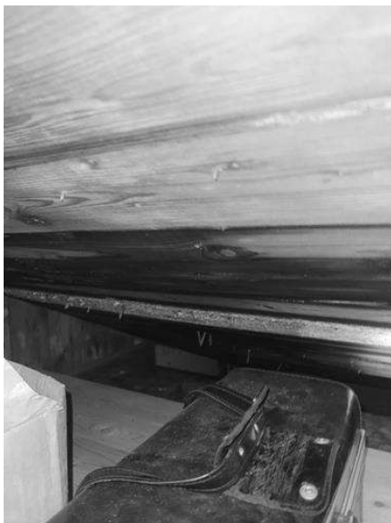
Kommentar - [Fuktmerker undertak råloft 3]
