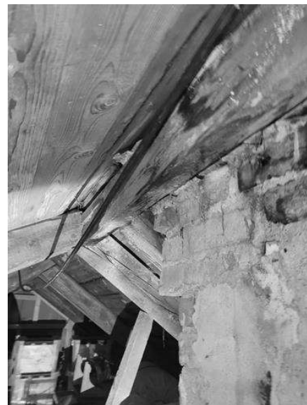
Kommentar - [Fuktmerker undertak råloft 2]
