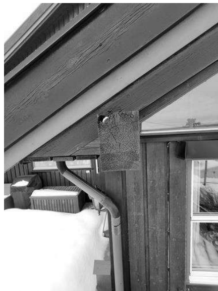
Kommentar - [Råteskade limtre]
