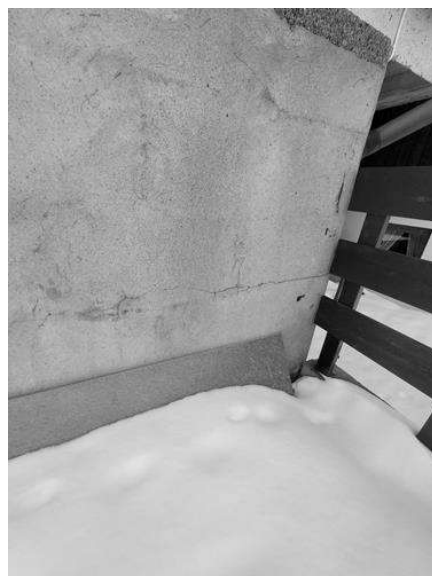
Kommentar - [Riss/sprekker i grunnmur 2]
