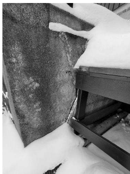
Kommentar - [Riss/sprekk støttemur ]
