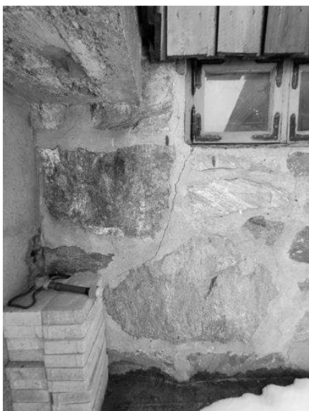
Kommentar - [Riss/sprekker i grunnmur 3]
