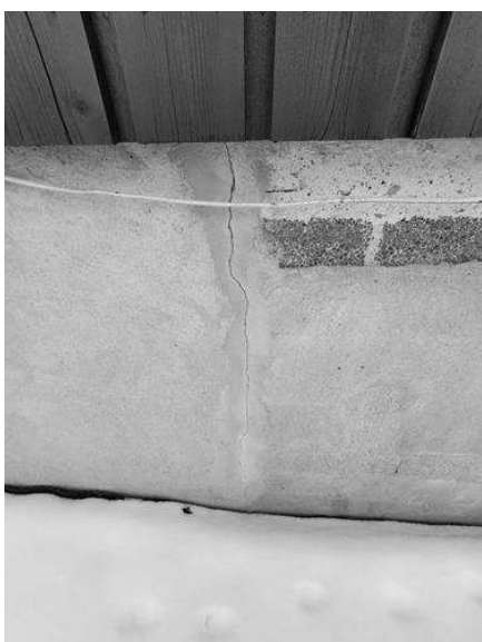
Kommentar - [Riss/sprekker i grunnmur 1]
