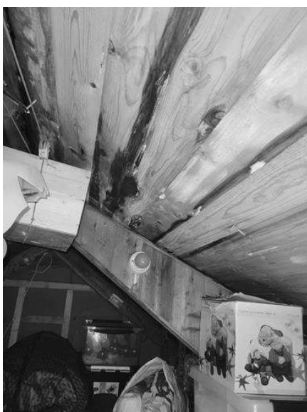
Kommentar - [Fuktmerker undertak råloft 1]
