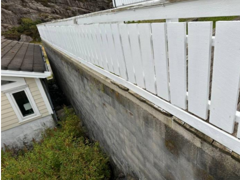
Mur med stedvise skjevheter.
