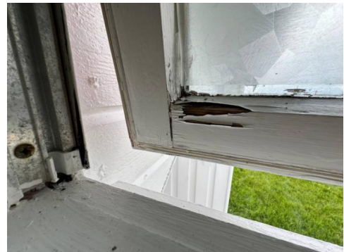
Et av vinduene med råte
