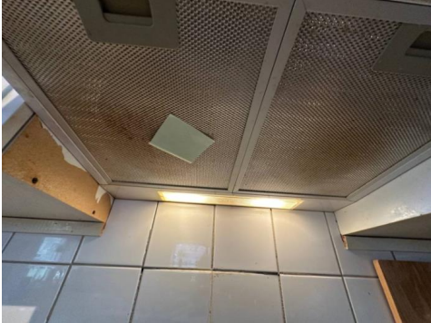
Ventilator bestod papirtesten. Avrevet laminat på venstre side.
