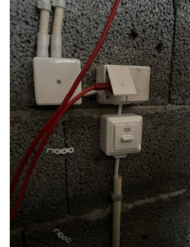
Varmekabel på utvendig vannledning
