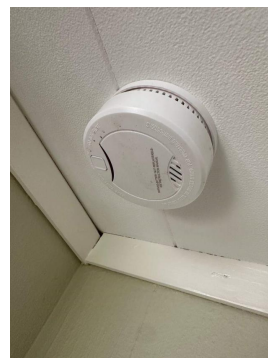
En av to røykvarslere i hovedbolig.
